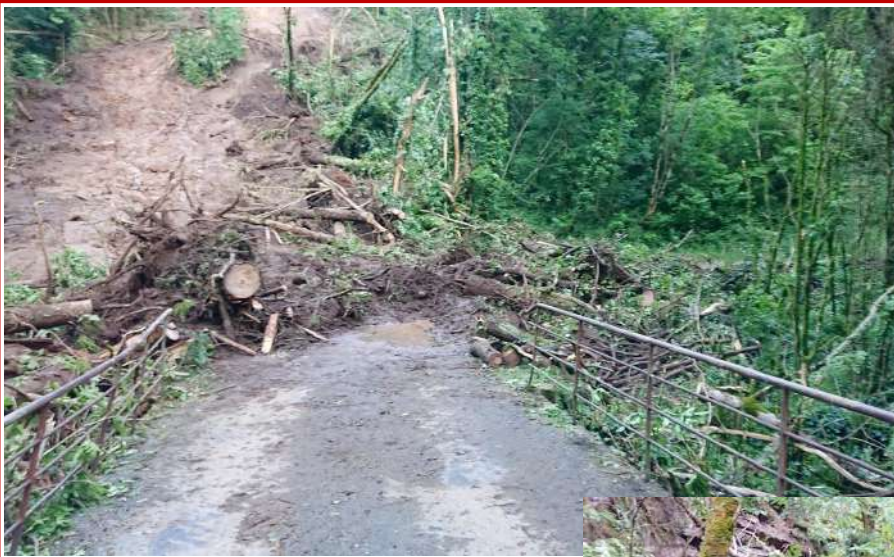
Glissement de terrain impressionnant au Saut de la Truite
